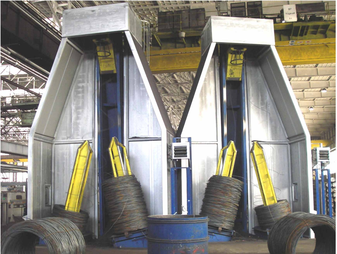
Walzdrahtablauf an den TEUREMA-Reckanlagen mit realisierten Schallschutzmaßnahmen
