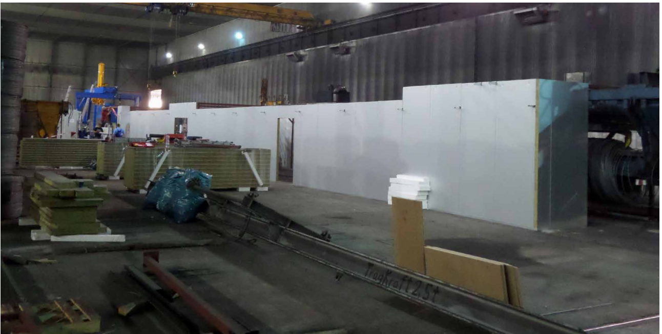
Kapselung Reckanlagen, Drahhalle (seit 2015)
