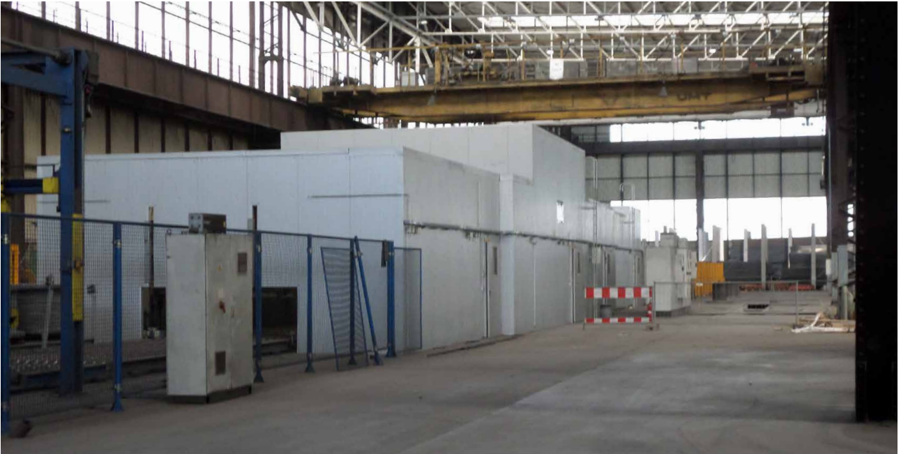
Kapselung Mattenschweißmaschine, Mattenhalle (seit 2015)
